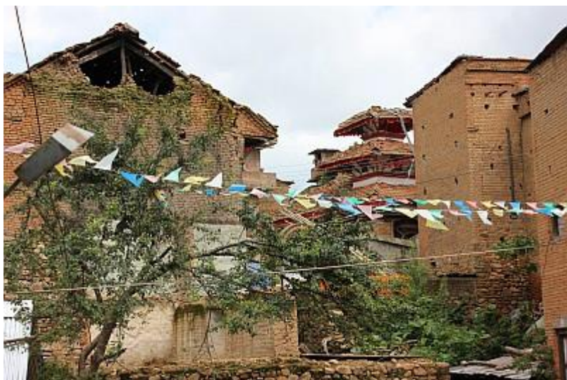
■寺院の塔上部も破損
